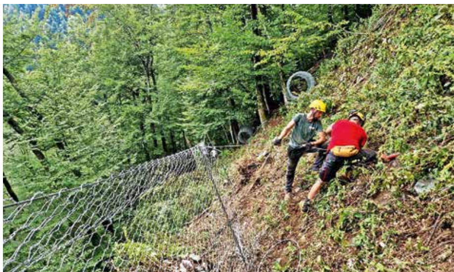
Najprej so pod območjem gradnje izvedli začasno varovanje z lahkimi lovilnimi palisadami. / Foto: Eho Projekt
